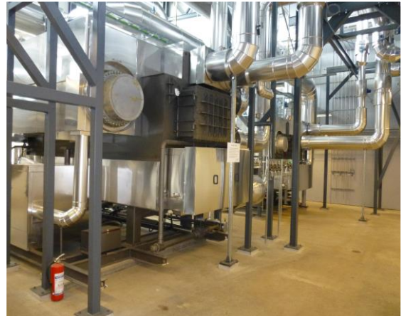
Figur 34: Absorptionsvarmepumpe efter installation (Sønderborg)
