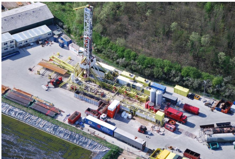
Figur 14: Borerig i Sønderborg, maj 2010 (foto: Sønderborg Fjernvarme).
